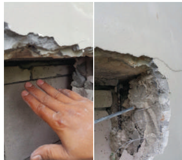
ผนังเดิมที่เป็น อิฐมวลเบา 2 ชั้นเว้นช่องอากาศ 5 cm. ที่เกิด condensation
