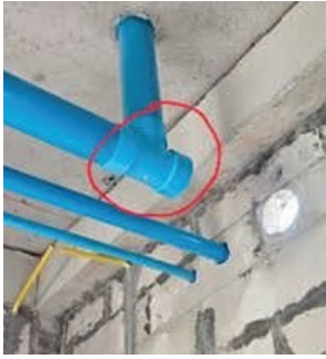
รูงานติดตั้งที่ไม่ถูกต้อง ไม่มี P-Trap หรือ U-Trap ชิงน้ำเพื่อดักกลิ่นย้อน
